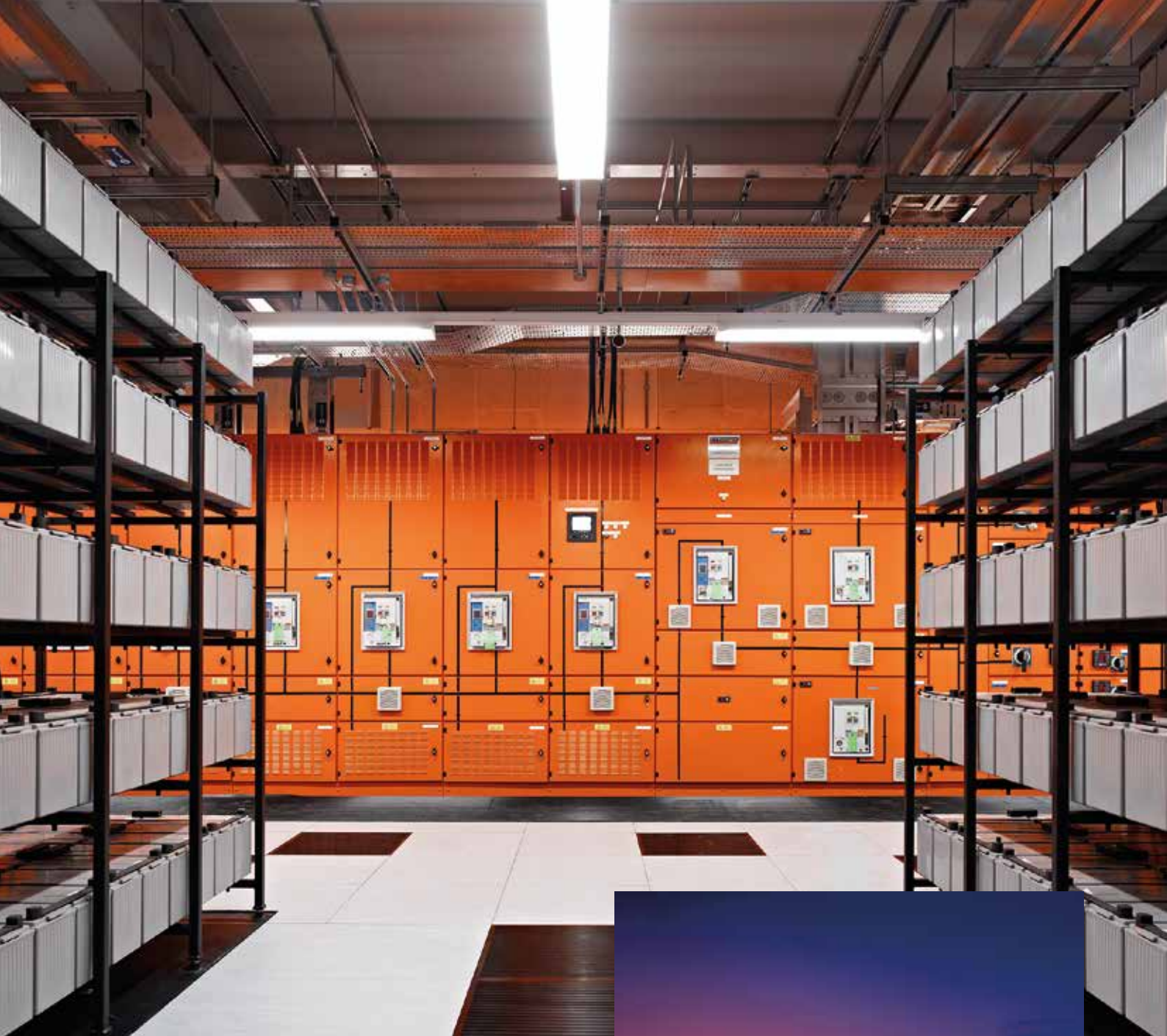
[Дата центрTeleouse в Лондоне: 199 воздушных выключателей TemPower 2, 423 выключателей в литом корпусе TemBreak 2]
